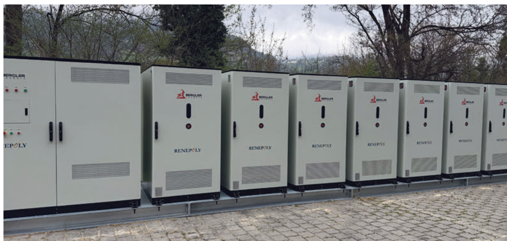
Hochleistungsbatteriespeicher in Maienfeld.
